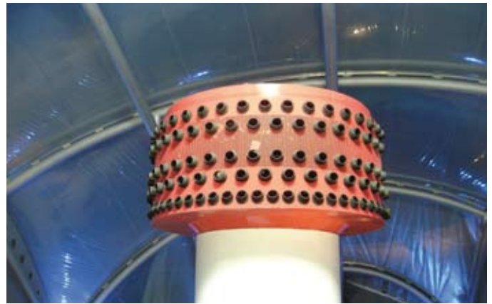
Einer der beiden Ausblasköpfe für die Luftverteilung im Schwimmbad
